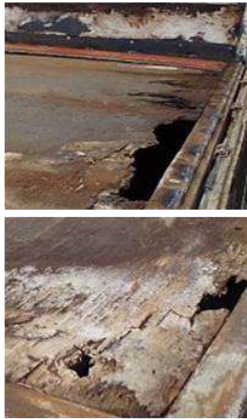
腐食による穴 剥がれ等(図1)
